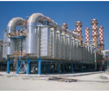
A thermal MED plant. Photo: Courtesy Sidem/Water Desalination Report.
